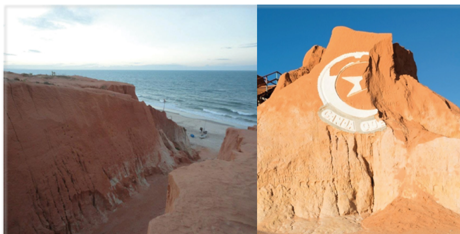
Figura 5. À esquerda, falésia em processo erosivo. À direita, símbolo tradicional de Canoa Quebrada (a lua e a estrela) esculpido em falésia, desmorona em função da erosão da mesma
